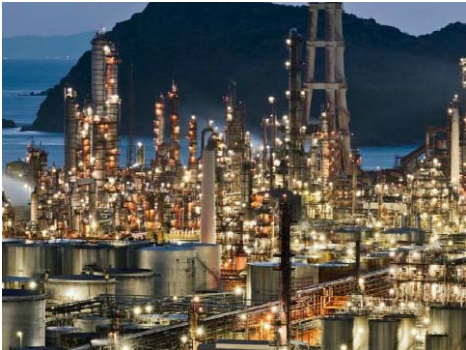
化学工場の配管、ポンプ
